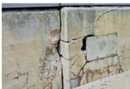
La fisuración, el cerramiento de las juntas y la dislocación lateral fueron causados por la severa reactividad álcali-agregado en este muro de parapeto.
