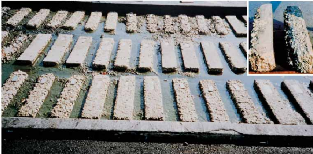
Vigas de hormigón después de muchos años de exposición a un suelo con alta concentración de sulfatos
